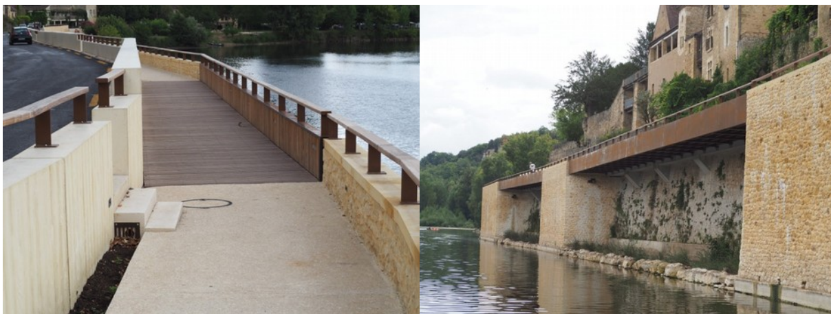
Vues de la déviation piétonne, au tiers ouest et en regardant vers l'est, et depuis la Dordogne, de l'est vers l'ouest, photos mission
